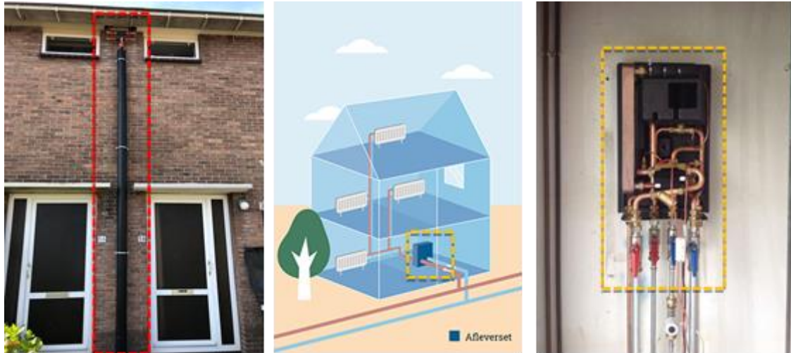
Afbeelding 5.10 Aansluitleiding langs de gevel en afleverset
